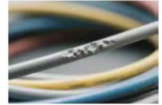
Обнаружение дефектов поверхности кабелей и проводов
