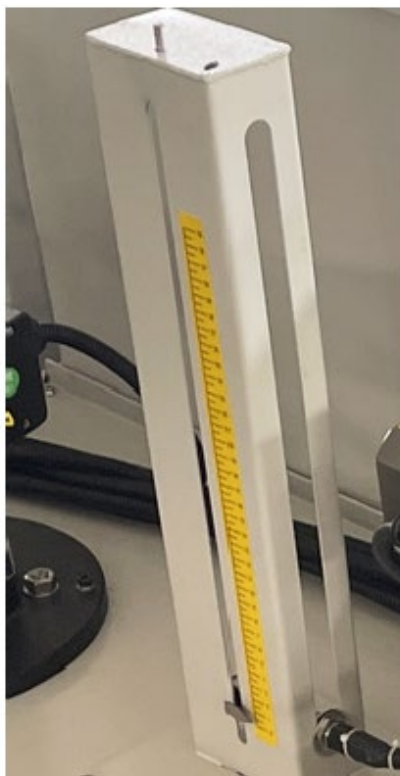
Контроль высокого и низкого уровня жидкости насоса
